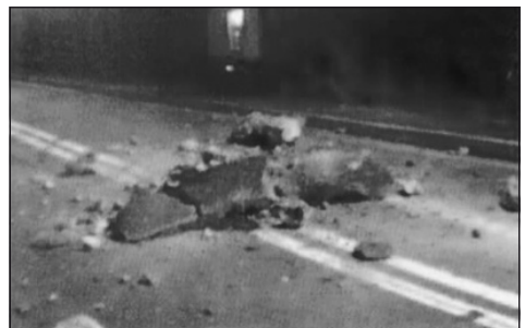
Stücke der Tunneldecke liegen auf der Fahrbahn
