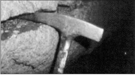
Risse im Tunnel noch und noch...
